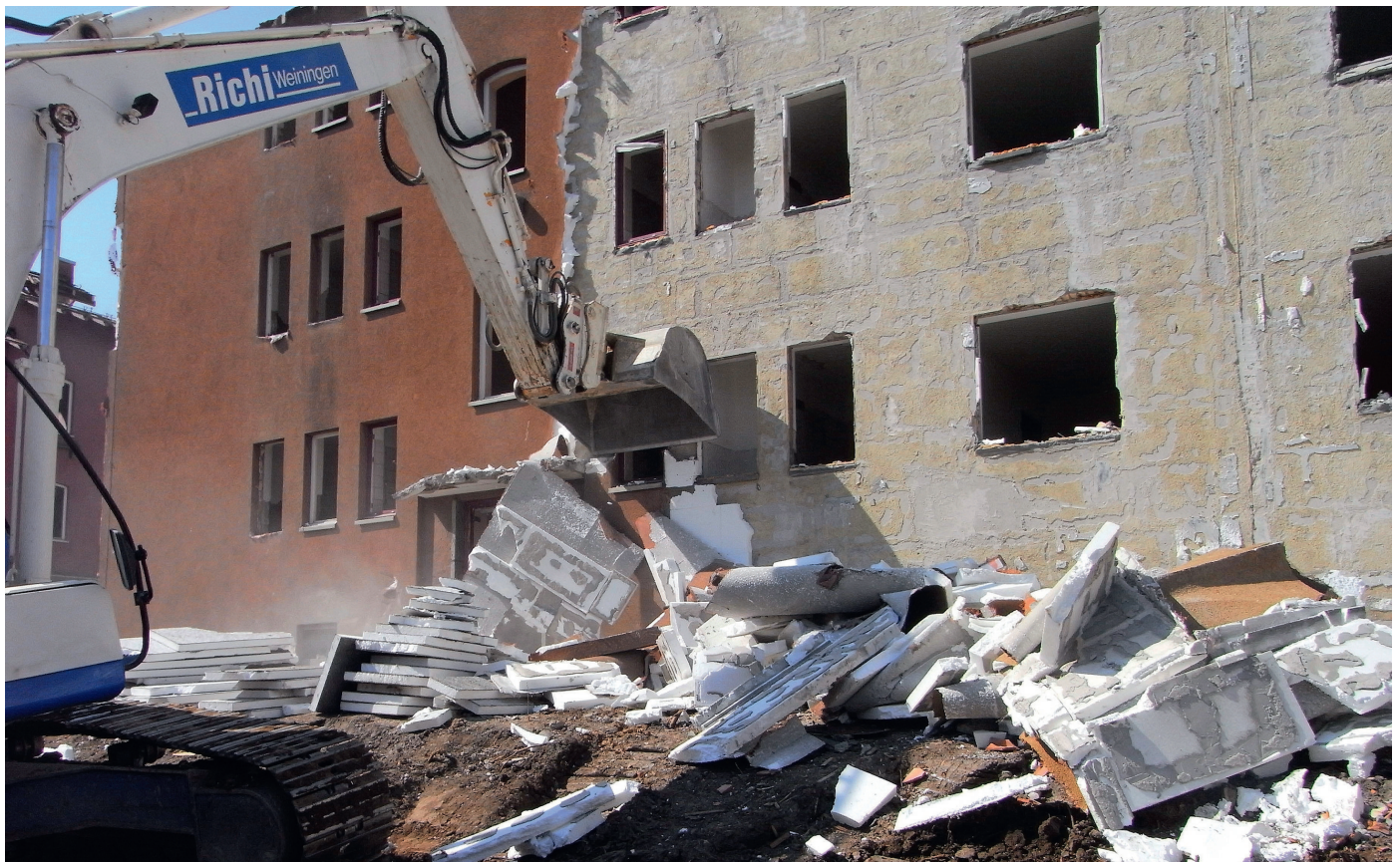
Abtrennung der gesamten Kompaktfassade vom Mauerwerk auf einer Baustelle in der Stadt Zürich. (Foto: Stefan Rubli, Energie- und Ressourcen-Management GmbH)
